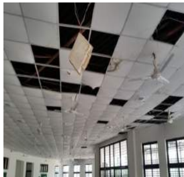
भवनको सिलिङको अवस्था
